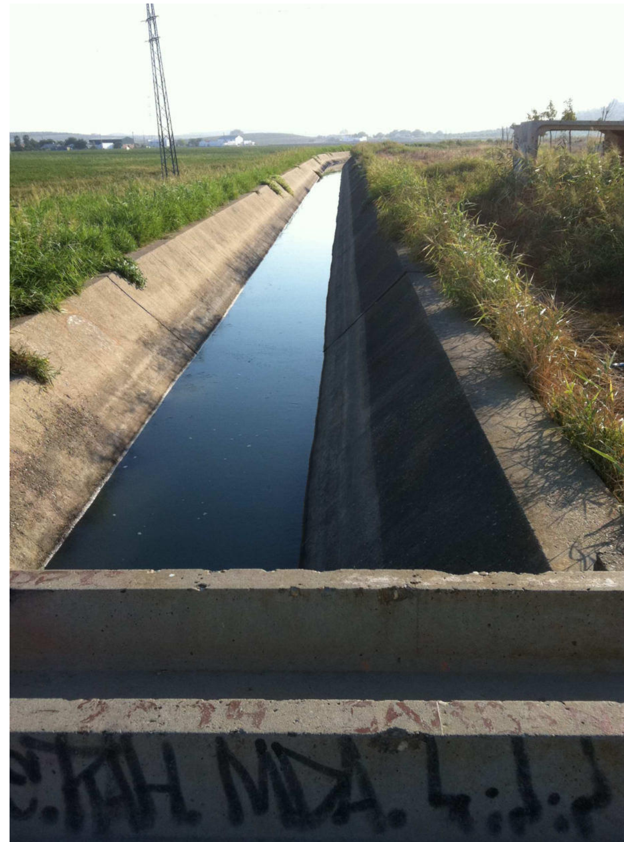
(Fotografía_27. Finalización del canal de riego cubierto. El canal hacia el pantano Torre del Águila)
